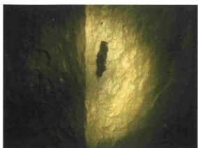
Microbiologisch geïnduceerde corrosie (MIC)
