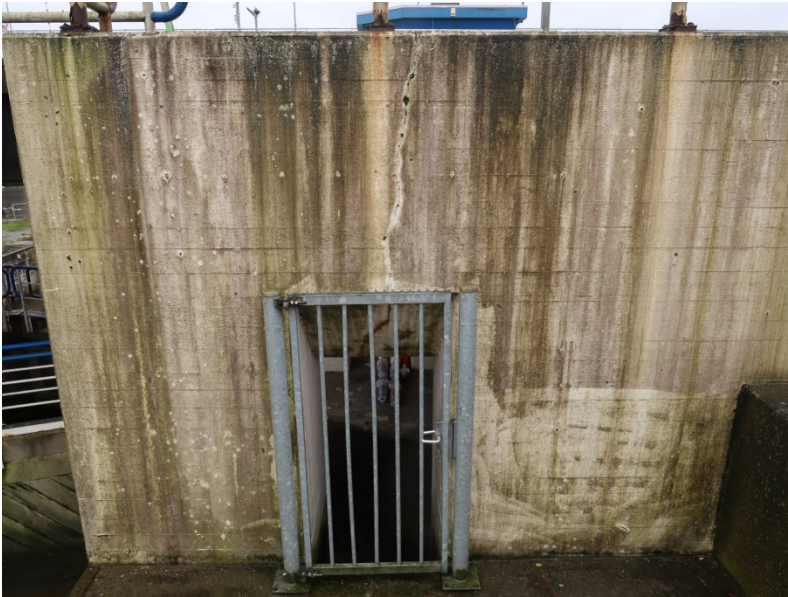
Foto 4: Verticale scheur in het zuidelijke landhoofd
