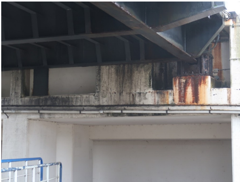
Foto 3: Corrosiesporen onder brugdek
