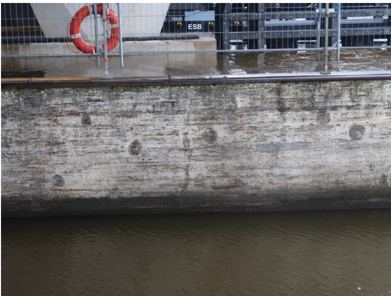
Foto 5: Verticale scheuren in de kolkwand
