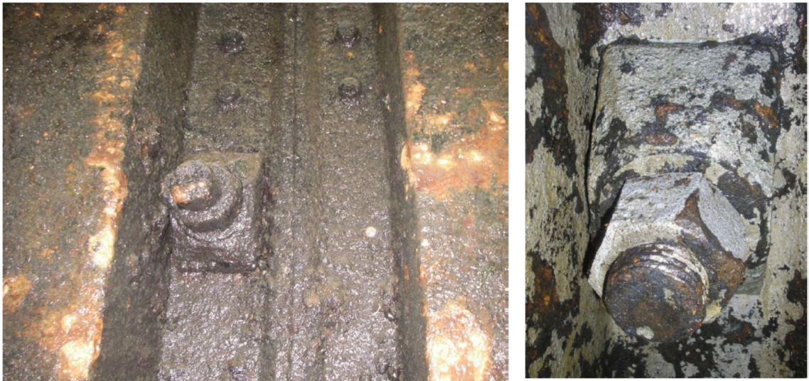
Figuur 2.11 Links een voorbeeld van een nog niet schoongemaakte locatie en rechts een schoongemaakte kop van de ankerstang waarbij [Acotec 2012a] aangeeft dat er sprake is van zware corrosie
